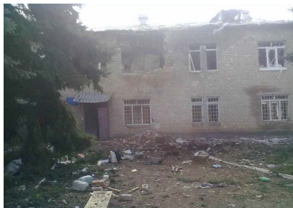
Разрушенное при боевых действиях здание ЭНЦ, 2014 г.
